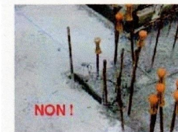
Fig. 14 Bouchons d'attente de diamètre insuffisant
